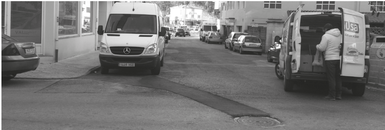
Vista de la calle Corbatas en Unquera. En primer término se aprecia la conexión del nuevo ramal de saneamiento a la red existente.
