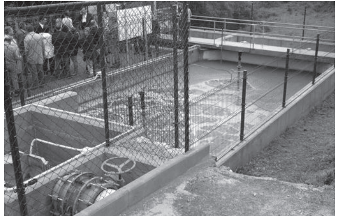
Vista de la depuradora de Pechón.
