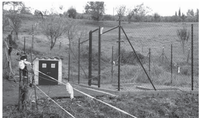
Estación depuradora de Helgueras.
